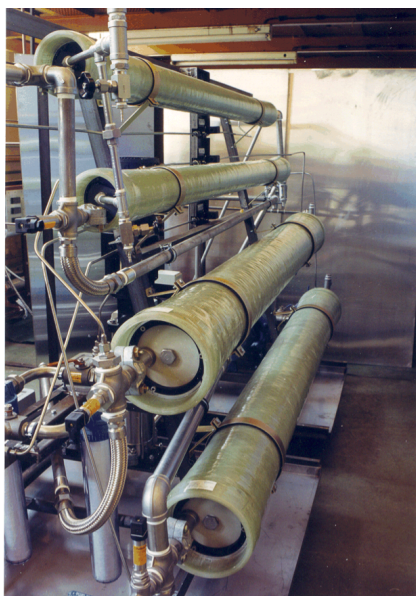
Rys. 23.6: Zestaw modułowy trzech jednostek membranowych używanych w Zakładzie Unieszkodliwiania Odpadów Promieniotwórczych w Świerku
