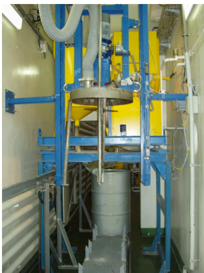
Rys. 23.9: Instalacja do cementowania odpadów promieniotwórczych
